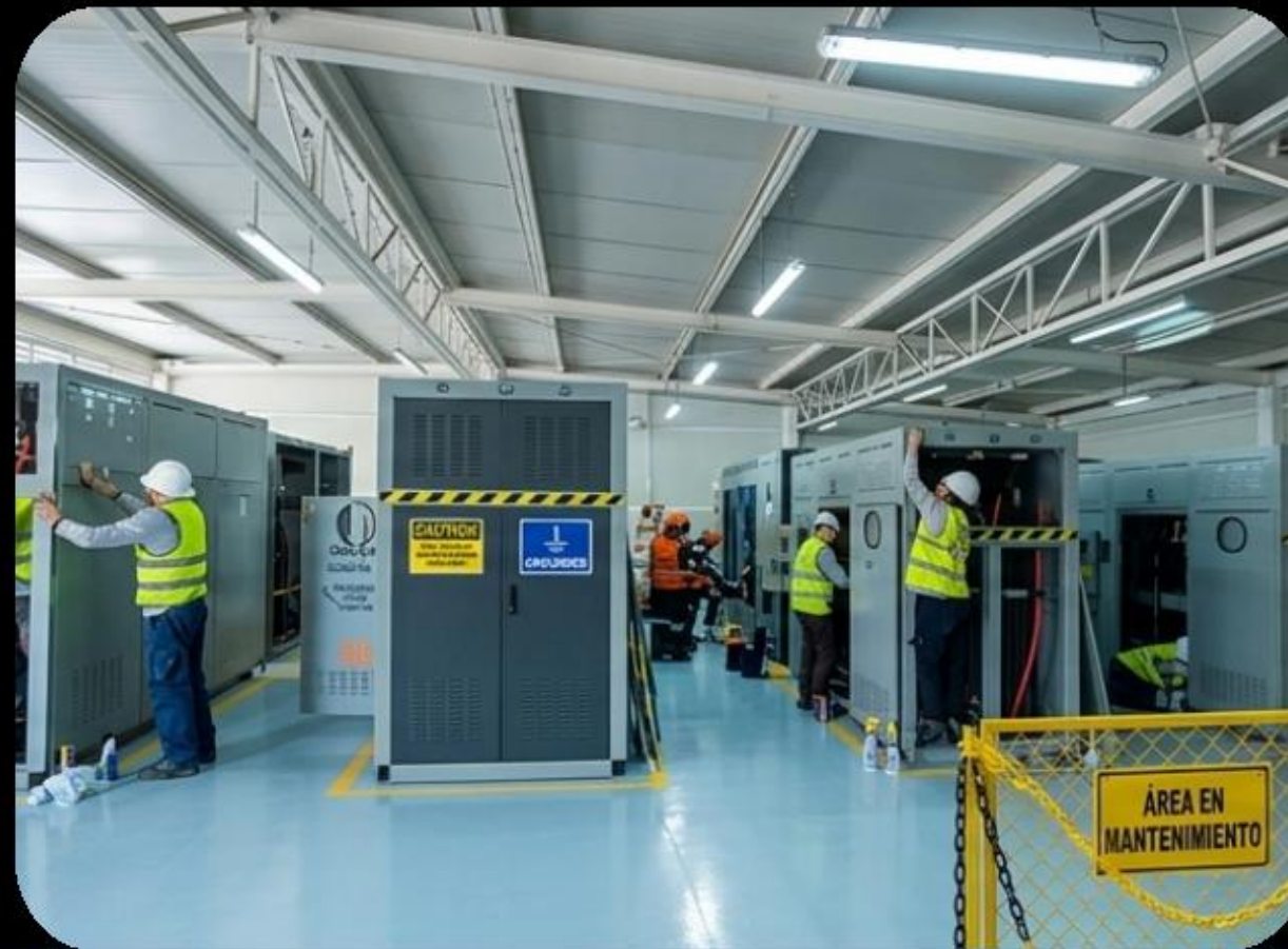
Mantenimiento a transformadores
