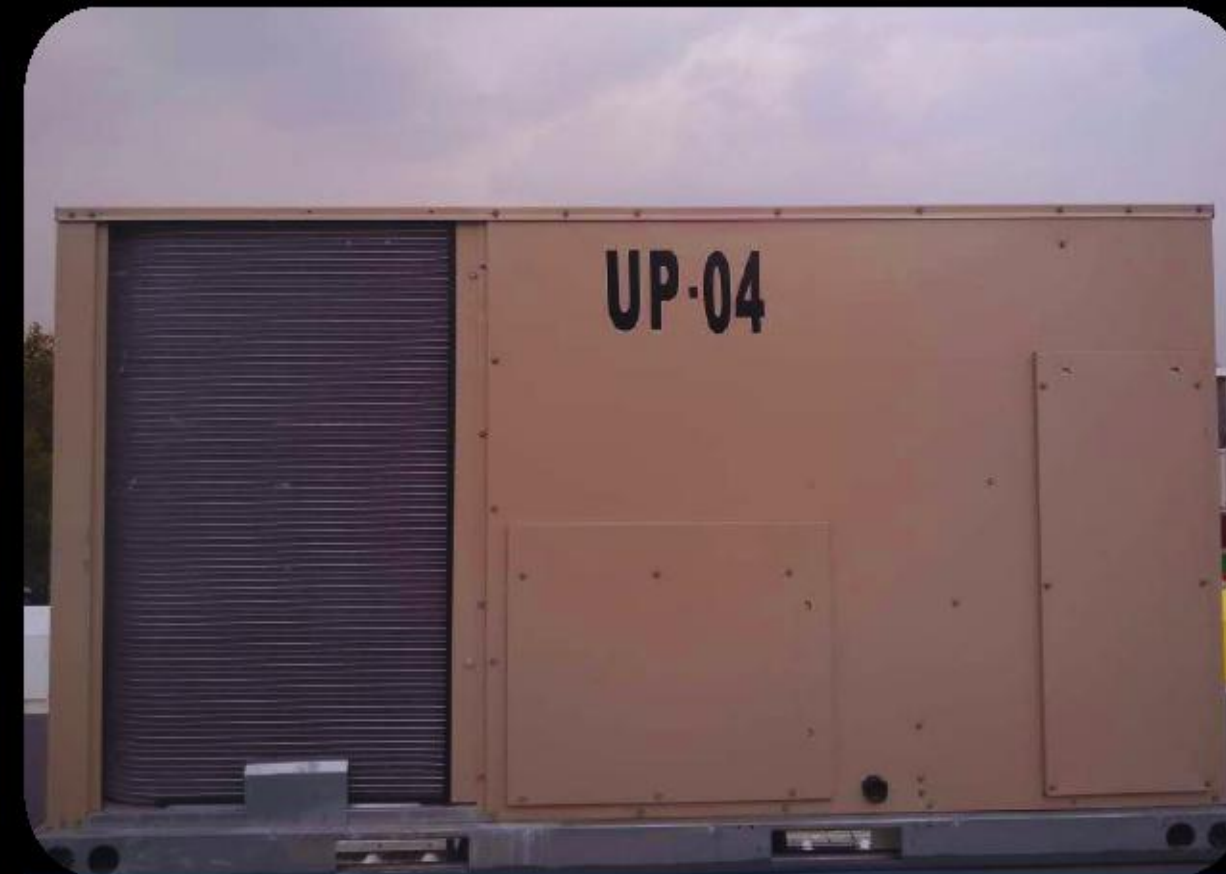
Implementación de sistema de climatización tipo rooftop
