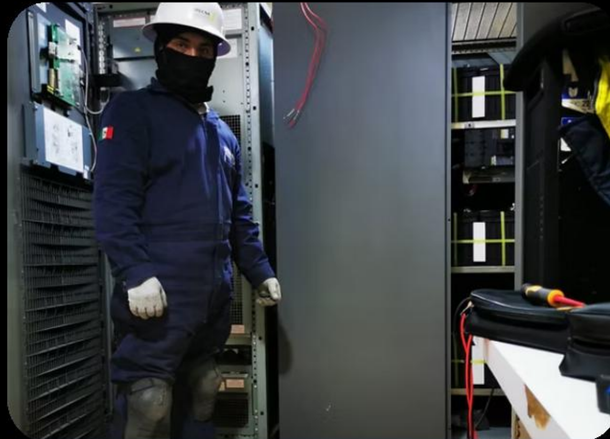
Instalación y mantenimiento de UPS
