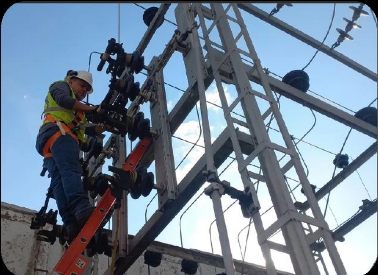
Instalaciones eléctricas de media tensión
