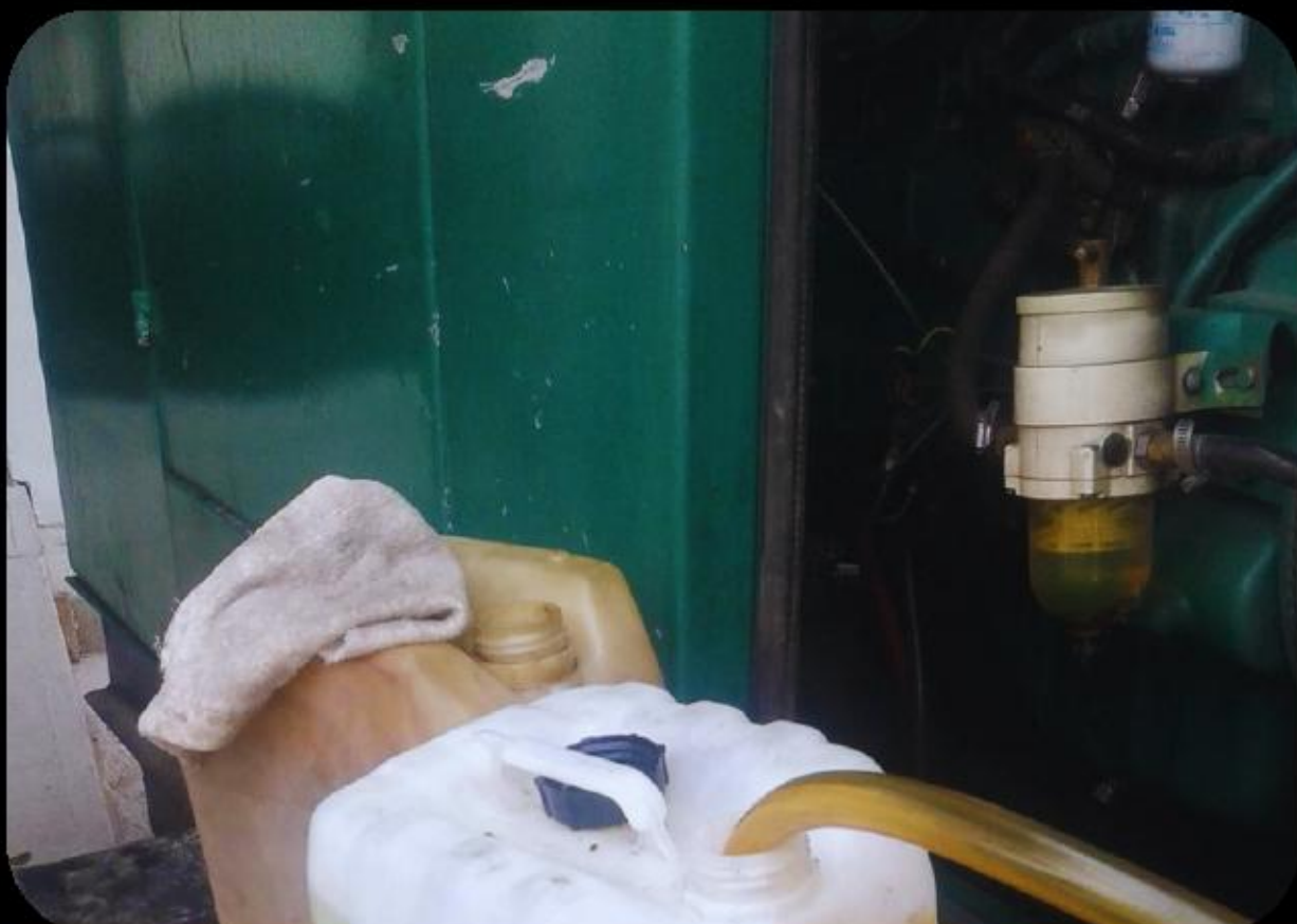
Mantenimiento de planta de emergencia
