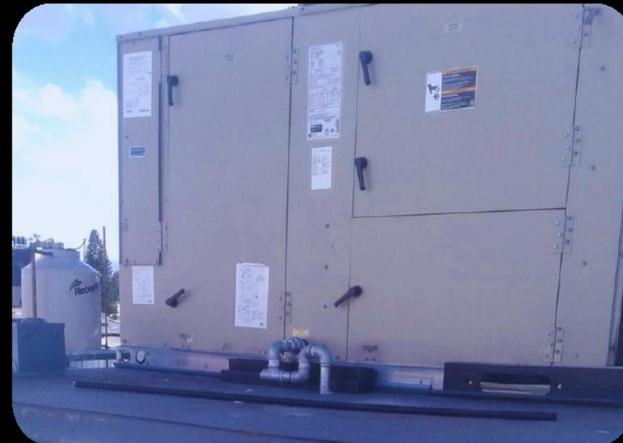
Conexión e integración de unidad paquete tipo rooftop
