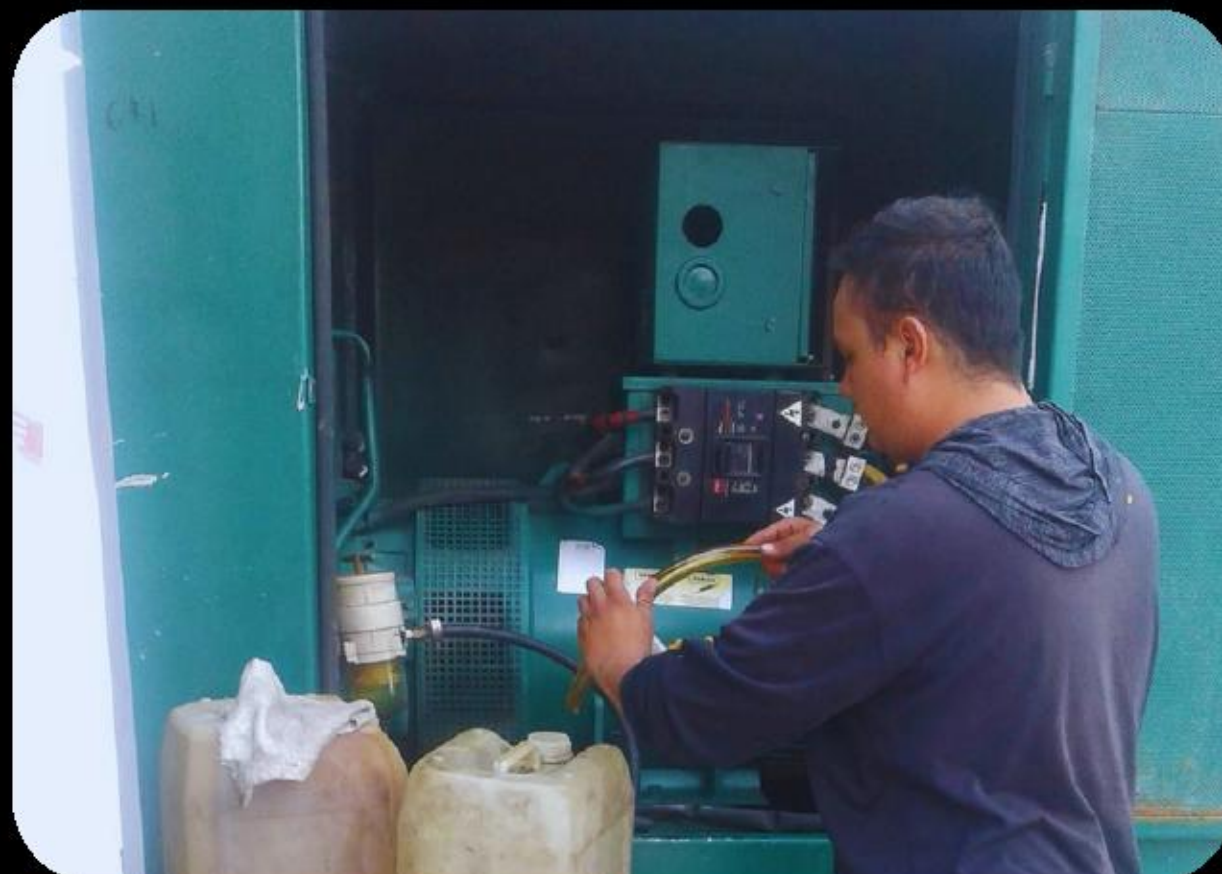
Operación y revisión de planta de emergencia
