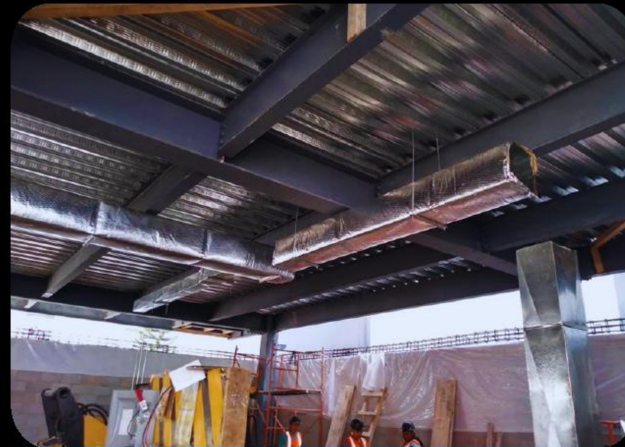
Integración de sistema de ductería para climatización
