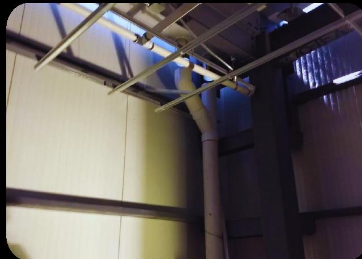
Sistema de ductería instalado para distribución de aire
