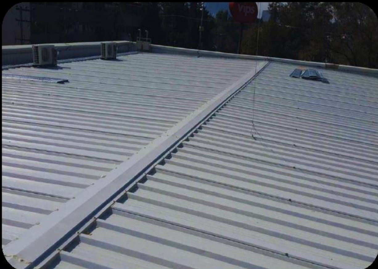
Integración de canalizaciones y servicios en cubierta para sistema HVAC
