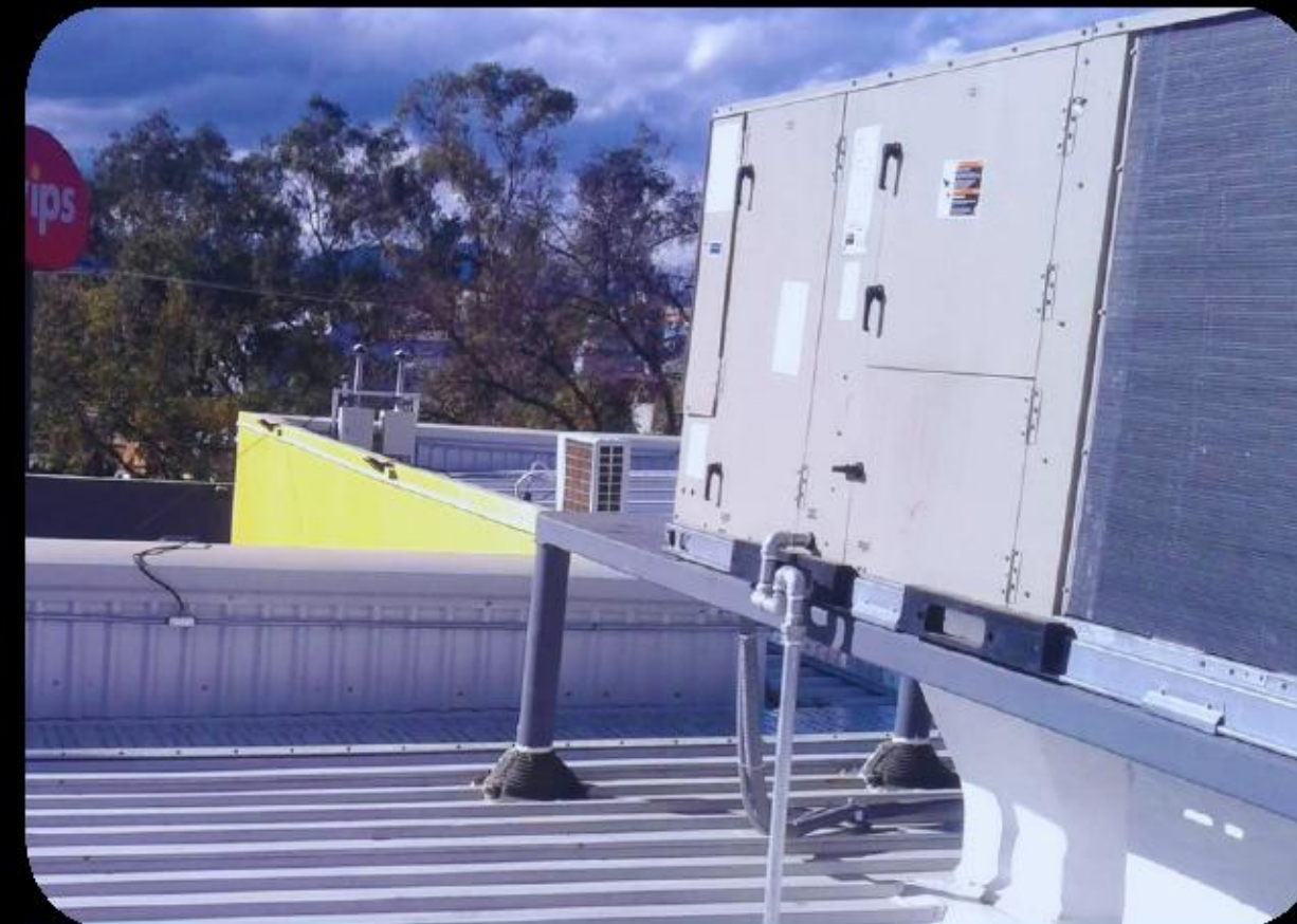
Integración de sistema de climatización en azotea con conexiones
