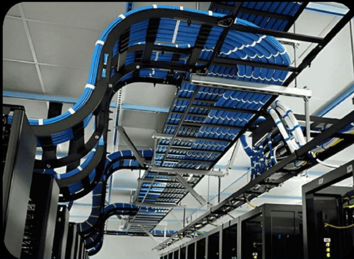
Instalaciones de cableado estructurado
